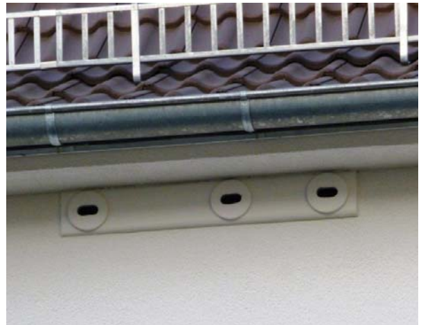
Abb. 5: Einbau-Niststeine (Foto: Ingolf Grabow, NABU, Frankfurter Mauersegler-Initiative)
