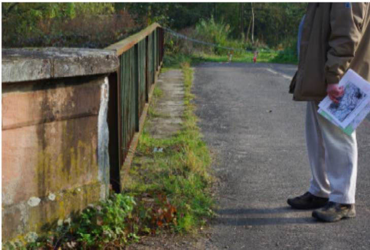
Im Detail: Aufwuchs von Vegetation auf der linken Brückenseite. Hier kann ein Vegetationsstreifen bis zu einem Meter Breite entstehen.
