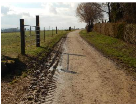
Abbildung 13: Verschmutzter Wirtschaftsweg (Foto: eigene Aufnahme)
