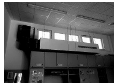
Lüftungsgerät Stephan-Gruber-Schule Geb. 1, Eppertshausen, Fertigstellung 04/2024
