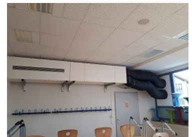
Lüftungsgerät Stephan-Gruber-Schule Geb. 1, Eppertshausen, Fertigstellung 04/2024
