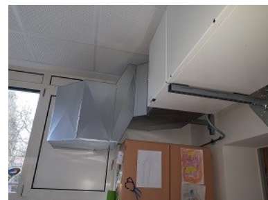
Lüftungsgerät Stephan-Gruber-Schule Geb. 2, Eppertshausen, fertig
