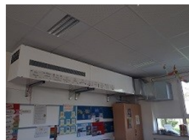
Lüftungsgerät Stephan-Gruber-Schule Geb. 2, Eppertshausen, fertig
