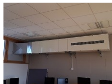
Lüftungsgerät Mira-Lobe-Schule Geb. 3, Eppertshausen, fertig
