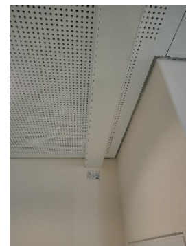
Brandschutzkanal mit Brandschott in der Wilhelm-Leuschner-Schule in Pfungstadt
