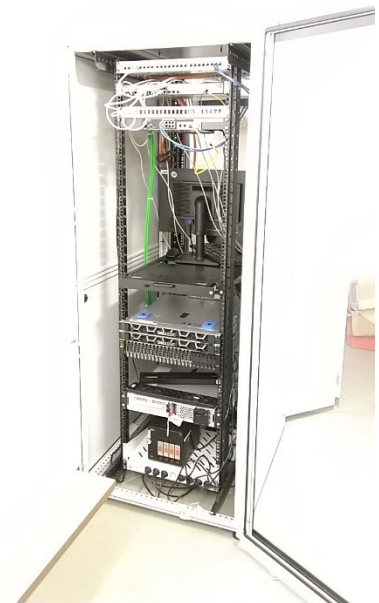
Datenverteiler in der Bachgauschule, Babenhausen
