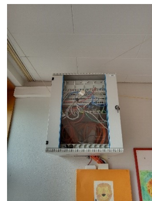
Datenverteiler PC-Raum in der Markwaldschule, Babenhausen/Langstadt
