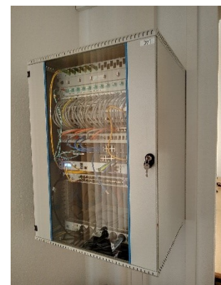
Datenverteiler DV-1 in der Grundschule im Grünen in Groß-Umstadt/Semd
