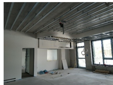
Klassenraum dezentrales Lüftungsgerät
